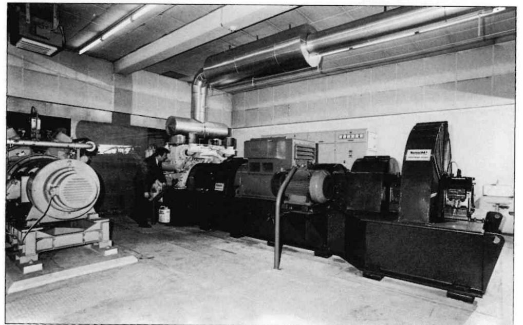
Notstromaggregat – 24 Stunden im Tag einsatzbereit
